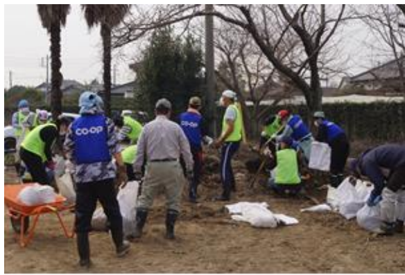
【庭に溜まった泥を撤去】
