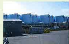
福島第一原発構内にある処理水を貯蔵したタンク
