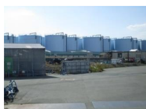
ALPS 処理水貯蔵タンク
